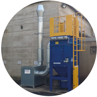
Ventilación general y unidad central de filtración
